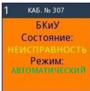
Рисунок 39 – Вид ярлыка объекта при неисправности
